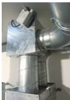
Umschalt- und Absperklappe
