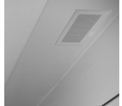
ComfoDuct C an der Decke
