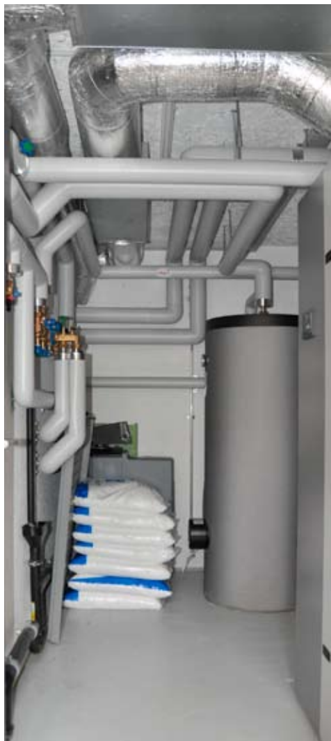
Rechts ist die Comfobox sichtbar, dahinter der Warmwasserbehälter. Bild: Kurt Grünig
